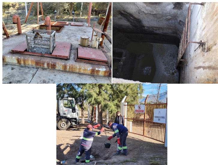
Figura N°4. Estación de Bombeo
